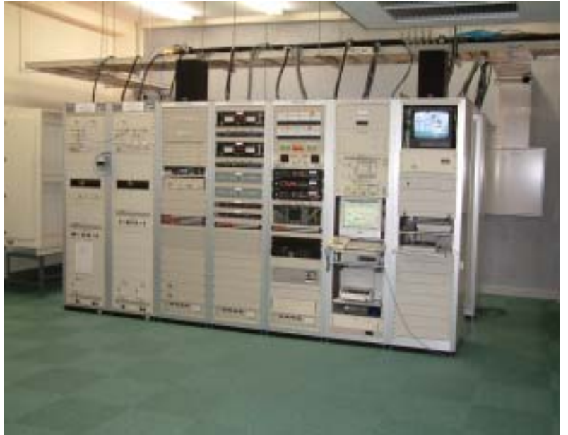
送信所・遠方監視制御装置その他
