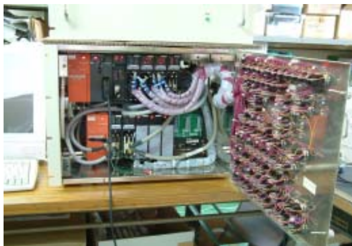
送信所 操作・表示盤の制御機器
